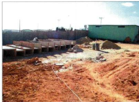
3ª expansão, em execução pela atual administração municipal. O sepultamento nesta área será o de gavetas. Foto: Marcela Borges, out de 2006
